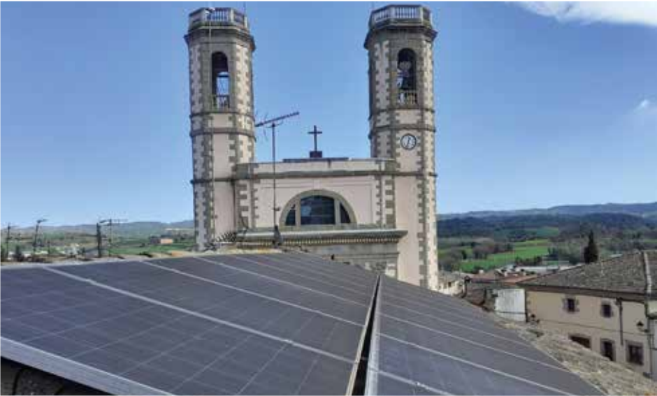
Plaques Fotovoltaïques a l'ajuntament. Març 2020.
